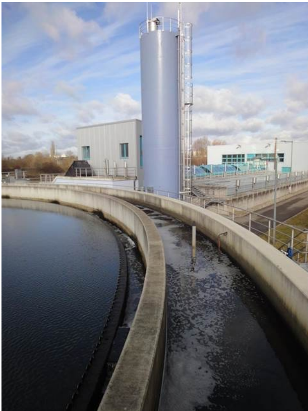
Der Zweckverband Kläranlage Böblingen-Sindelfingen betreibt seit 2011 eine Verfahrensstufe, um Spurenstoffe zu eliminieren. © KomS
